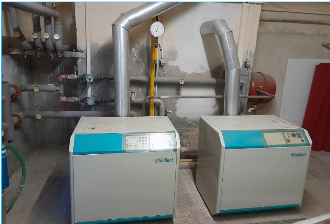
Obrázek 3 Stávající plynové kotle v objektu obecního úřadu
